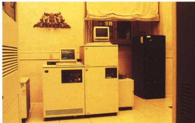
► Un'unità di controllo e il rack con i modem per i collegamenti esterni del CED del Senato.
