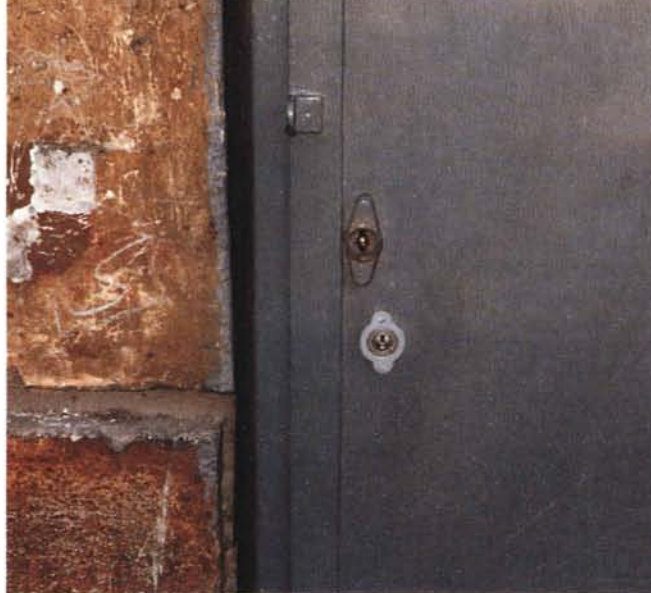
I «permutatori stradali» della SIP, comunemente detti «armadi» sono facili da aprire per installare dispositivi di intercettazione. Solo in alcuni casi la società telefonica ha installato serrature abbastanza valide, come quella che si vede in questa foto.
