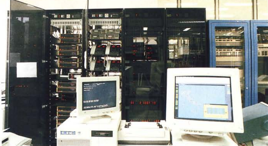
La sala di controllo delle telecomunicazioni di un CED.
