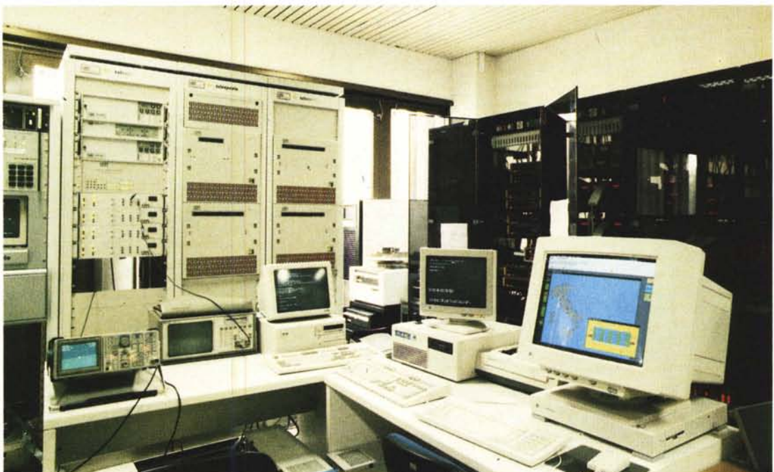
La sala di controllo delle linee esterne. A sinistra i collegamenti via satellite, a destra i modemi delle linee via cavo.
