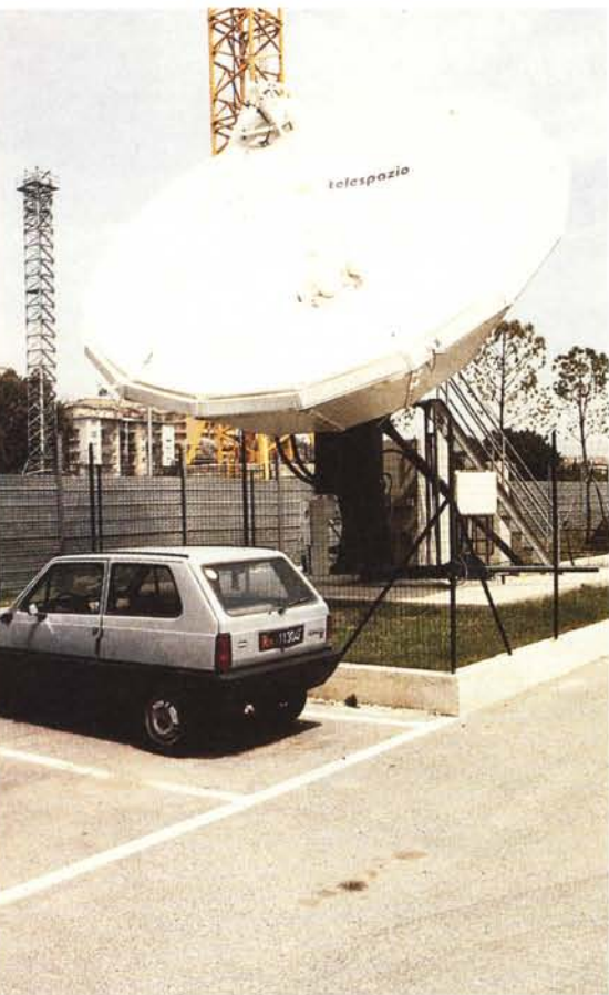
L'antenna parabolica che collega il CED della Motorizzazione ai concentratori degli uffici periferici.
